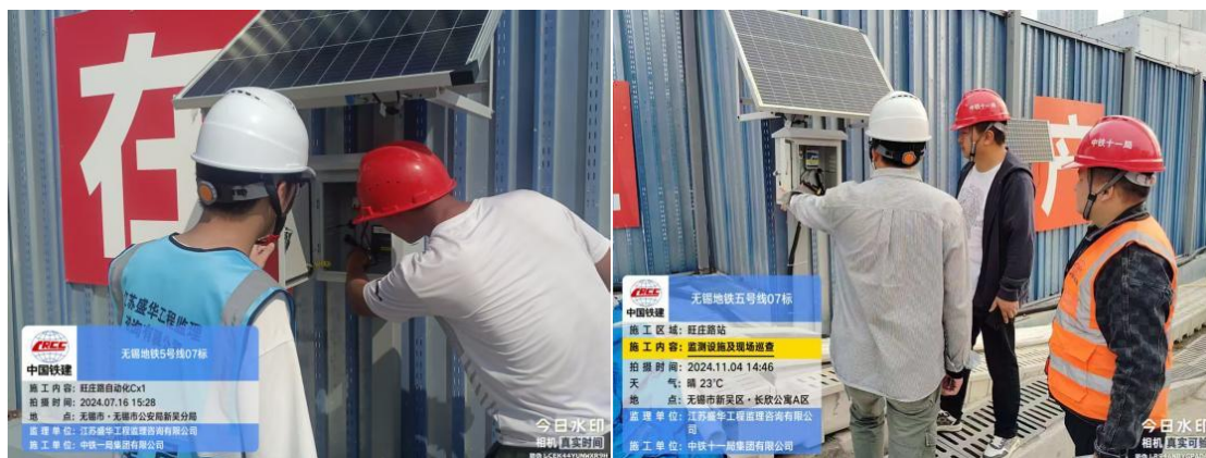
图 6 自动化监测太阳能板及数据传输控制器安装图
