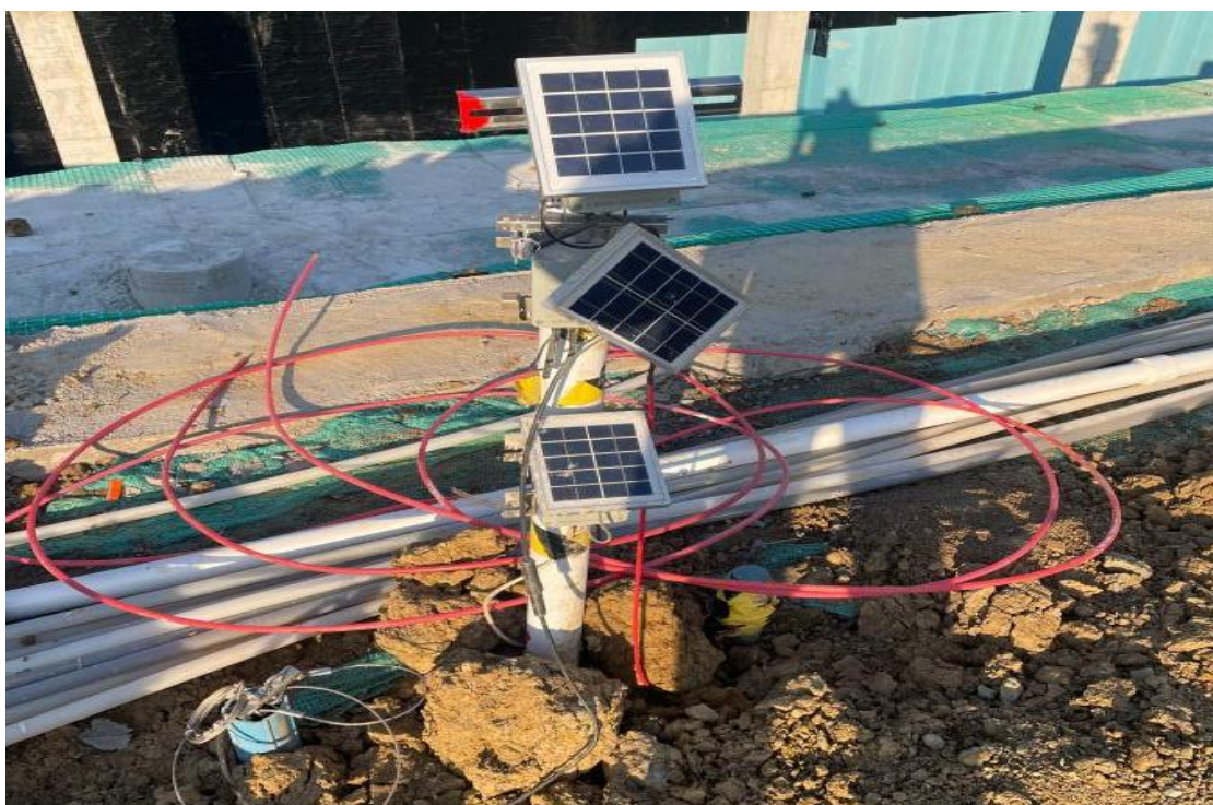
图4 深基坑监测预警装置现场照片
