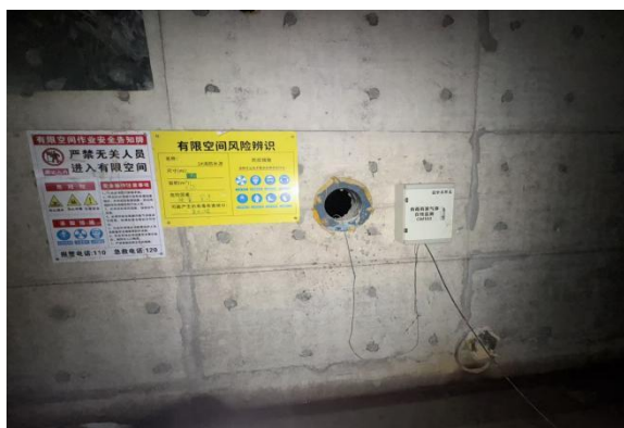
图14 固定式在线监测系统ZC-GDS100现场应用
