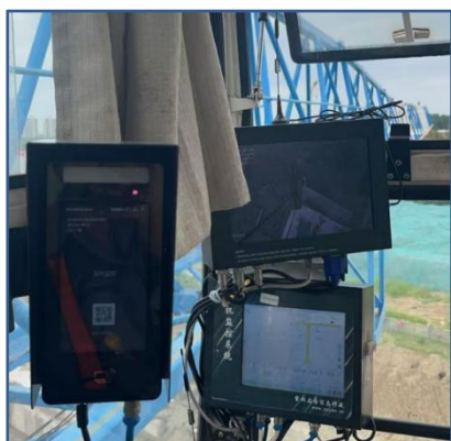
图13 塔吊驾驶室监控设备
