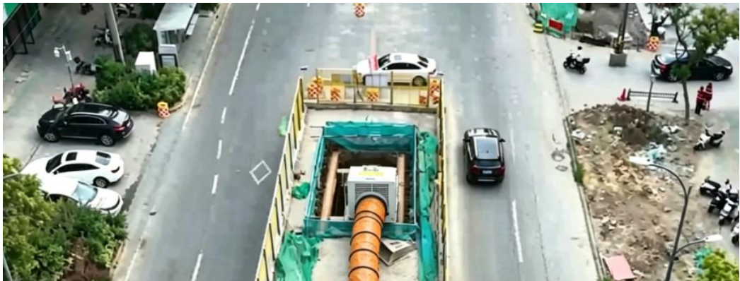
图14 深基坑作业送排风系统
