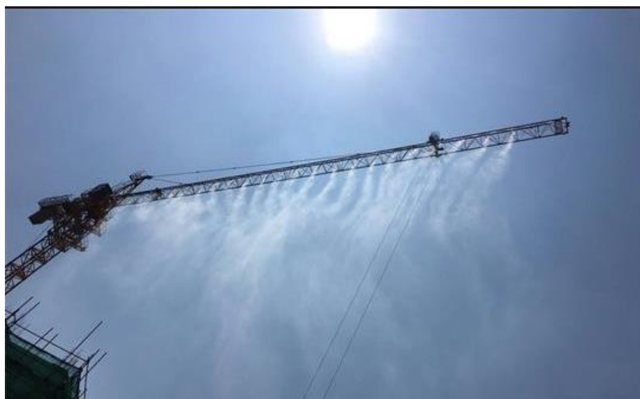
图4-6 改装后的智能喷淋设备
