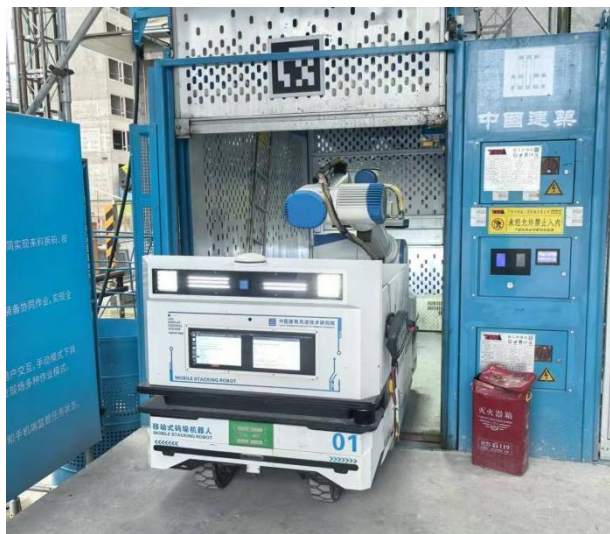
图6 机器人自主进电梯照片
