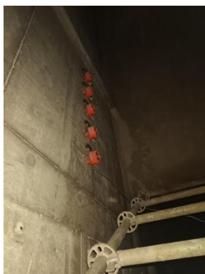
图13 气体探测器现场应用
