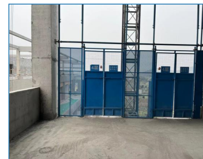
楼层悬挑平台侧面防护
