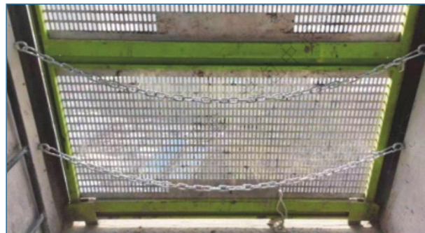
施工电梯设置防冲撞铁链
