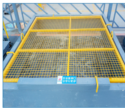
电梯井洞口防护
