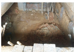
违规开挖地下室
